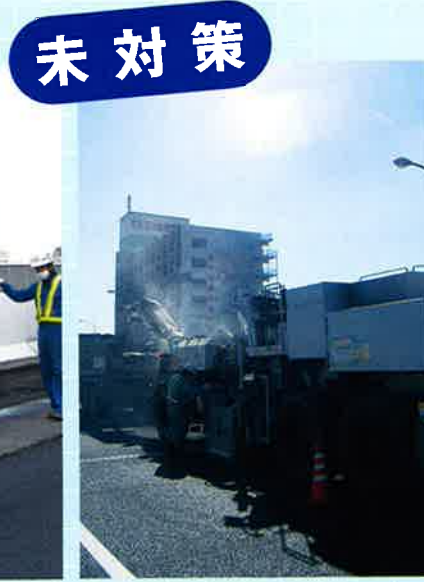
■粉塵未対策での施工
