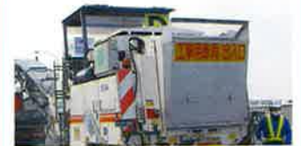
騒音低減装置の稼働状況
